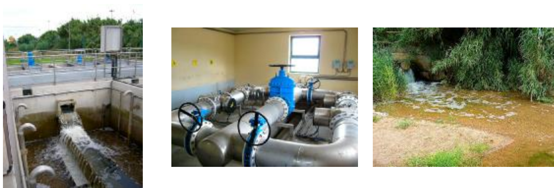
Figures 1 - 3. Imatges del procés de regeneració d'aigua de Blanes i de l'aigua regenerada produïda: a l'esquerra, detall dels filtres; en el centre, equips de desinfecció amb llum ultraviolada; i a la dreta, imatge del punt d'abocament de l'aigua regenerada a la llera del riu Tordera.
