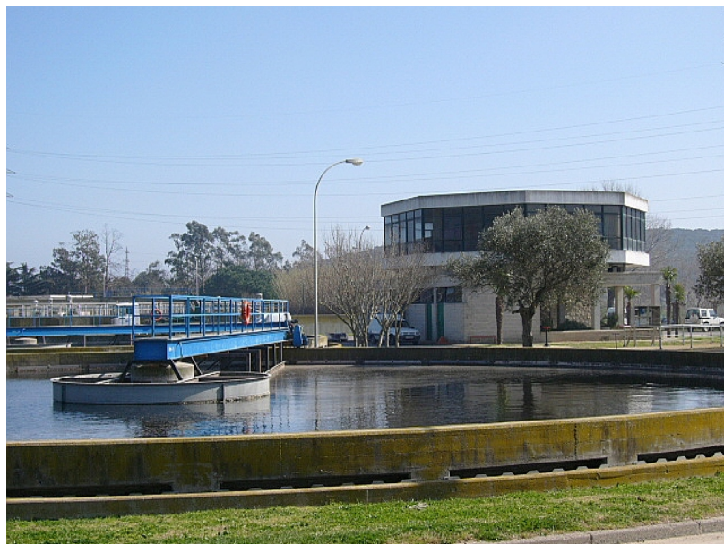
Figura 1. Vista general de l'estació depuradora d'aigües residuals (EDAR) de Castell-Platja d'Aro
