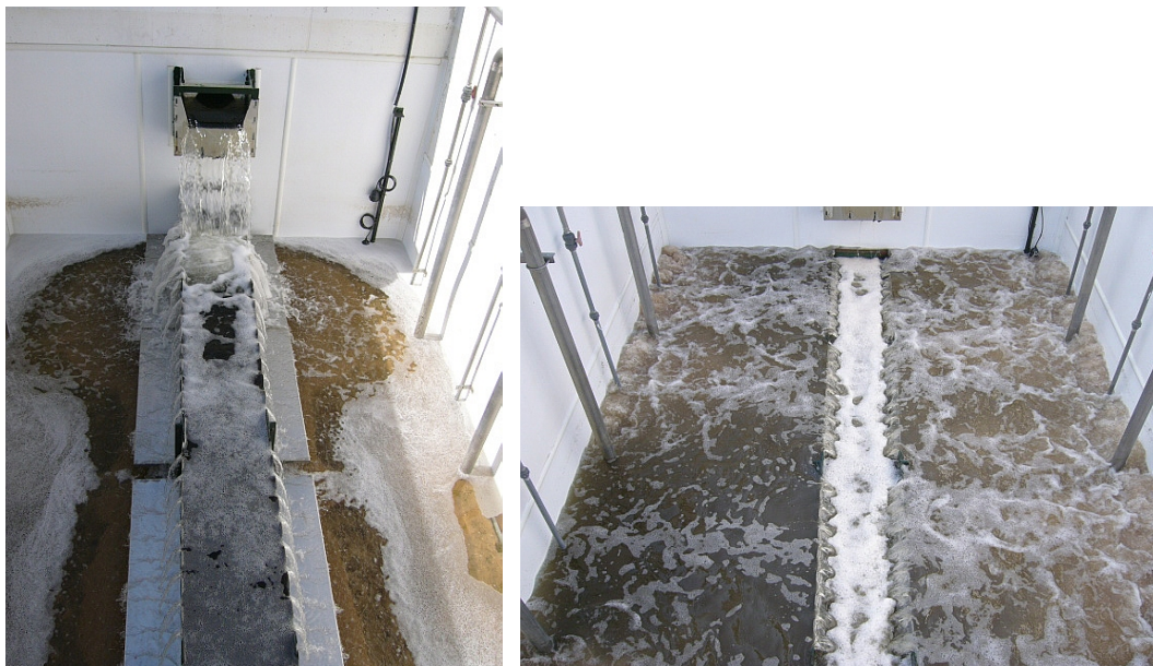
Figures 2 i 3: Filtració de l'efluent secundari a la planta de regeneració d'aigua de Castell-Platja d'Aro. Esquerra: funcionament normal del filtre. Dreta: Filtre en fase de contrarrentat.
