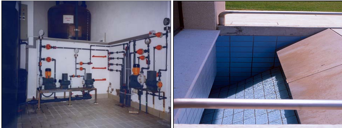
Figures 6 i 7. Vista general de la sala de dosificació de reactius i de l'aigua regenerada produïda a la planta de regeneració d'aigua de Castell-Platja d'Aro.
