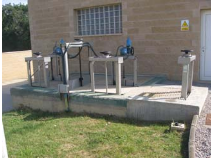
Figura 4.1. Punt d'arribada de l'aigua d'entrada a l'EDAR.
