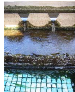
Figura 4.5. Detall del sobreexidor del decantador secundari.
