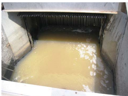
Figura 4.17. Inici del procés de depuració.
