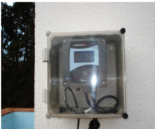
Mesura terbolesa a l'entrada del tractament de regeneració
