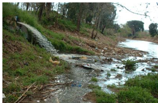
Ruptura de col·lector aigües amunt del P4, abril 2003
