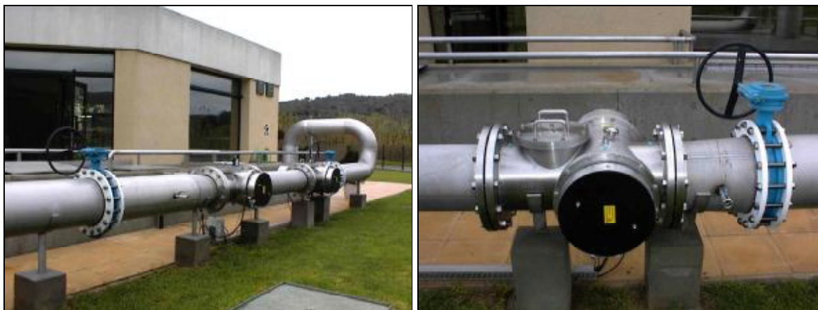
Figures 4 i 5. Vista general i de detall dels equips de desinfecció amb llum UV instal·lats a la planta de regeneració d'aigua de Castell-Platja d'Aro.
