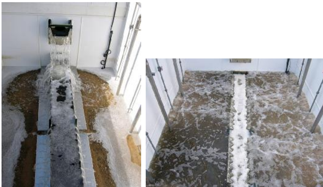
Figures 2 i 3: Filtració de l'efluent secundari a la planta de regeneració d'aigua de Castell-Platja d'Aro. Esquerra: funcionament normal del filtre. Dreta: Filtre en fase de contrarentat.
