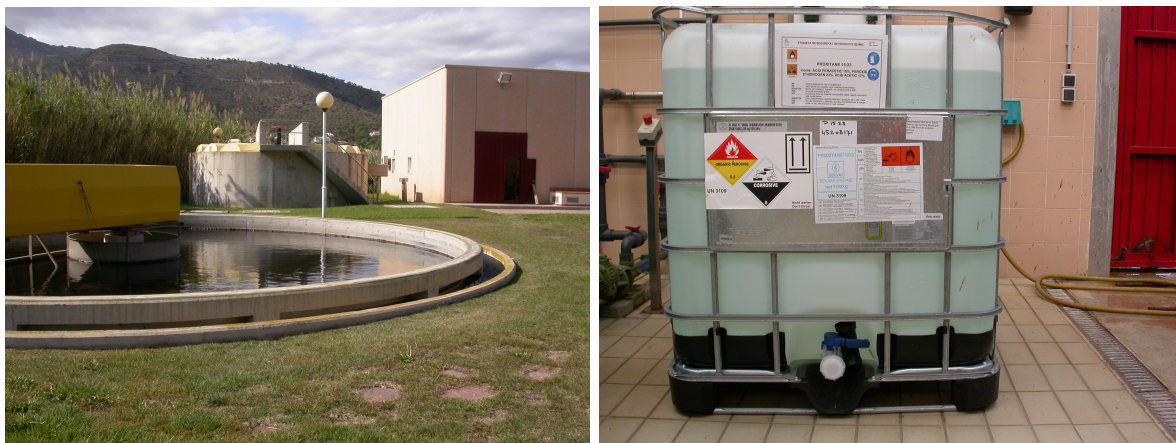
Figura 42. Depuradora de Port de la Selva (esquerra) i dipòsit de l'aplicador del peracètic (dreta) l'any 2008.
