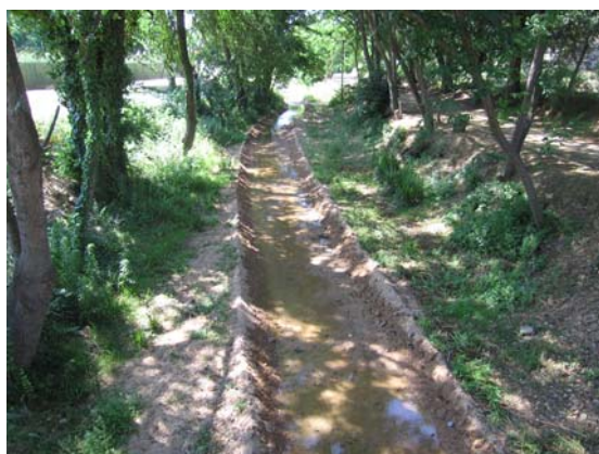
Figura 22. Canalització de la riera de Tossa a l'alçada del càmping Can Martí (riera avall del punt To2) el juny de 2007.
