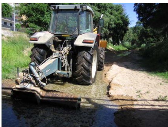
Figura 21. Canalització de la riera de Tossa a l'alçada de l'hotel Soms Park (riera amunt del punt To6) el 15 de juny de 2007.
