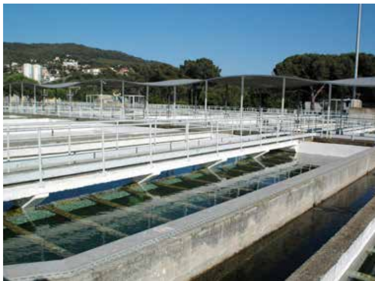
Detall del decantador de la potabilitzadora del Ter a Cardedeu, a l'ATL ETAP Ter Cardedeu.
