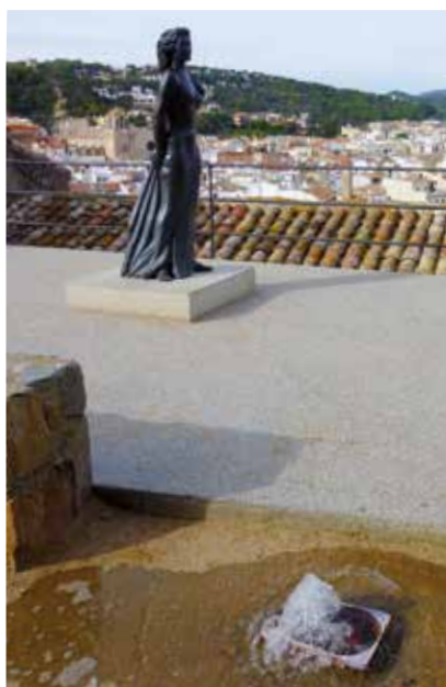
Hidrant de la xarxa d'aigua regenerada de Tossa, al costat de l'estàtua d'Ava Gardner realitzada per l'escultora Ció Abellí. Autor: Lluís Sala.
