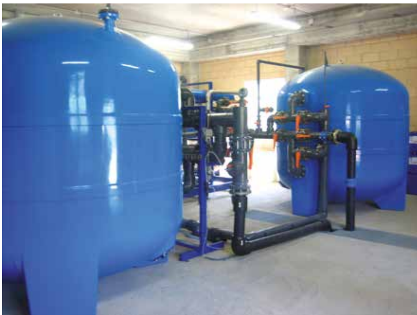
Filtres de la planta d'osmosi de Colera. Font: Agència Catalana de l'Aigua.
